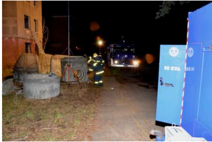
Aufbau der Beleuchtung
